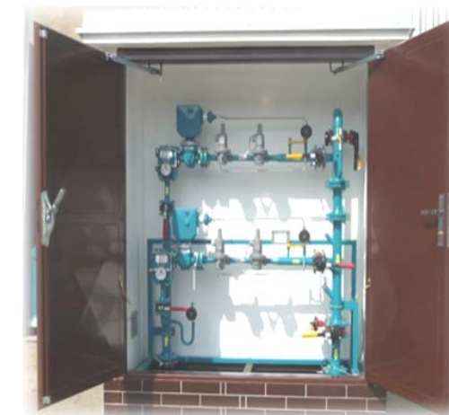
RESO v prefabrikovaném objektu
